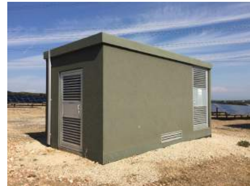
Photo 3 : Exemple de poste de conversion « indoor »
