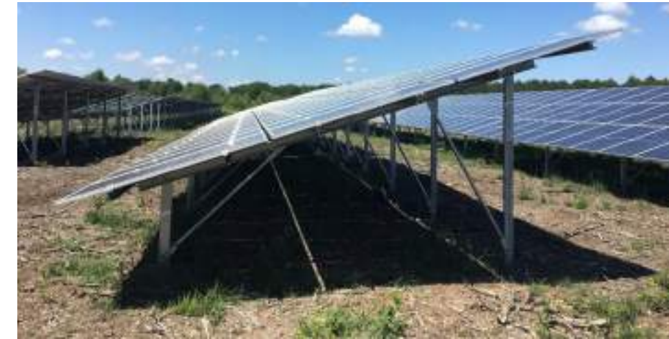
Photo 10 : Exemple de structure de tables fixes
