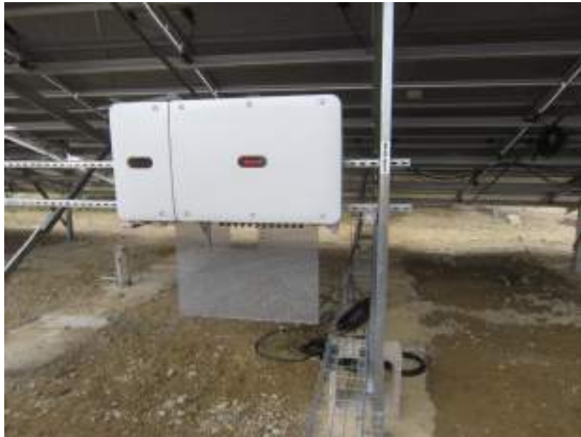
Photo 4 : Exemple d'onduleur décentralisé
