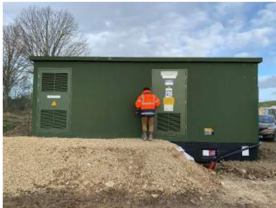
Photo 5 : Exemple de poste de livraison
