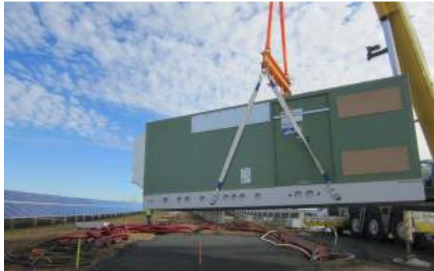
Photo 12 : Exemple d'installation de poste de conversion
